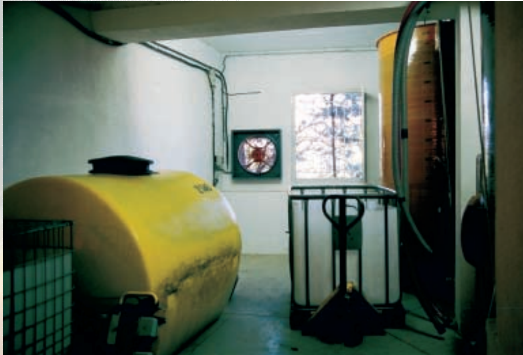
Exemple de ventilation générale pour l'ensemble de la cave
