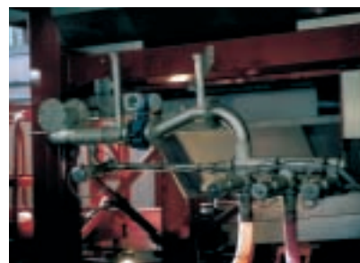
Régulation en fonction des débits à l'aide de débit mètres électromagnétiques
